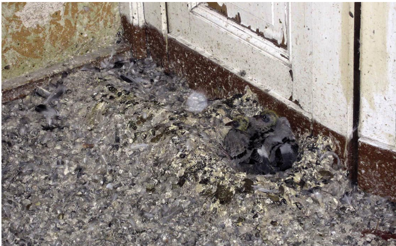
Abbildung 3: Dachböden, in denen Straßentauben brüten, können hochgradig mit humanpathogenen Mikroorganismen belastet sein.
